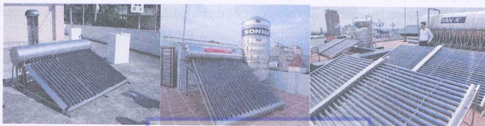
(a) Hệ thống đun nước tại nhà đơn lẻ (b) Hệ thống đun nước tại Viện dầu khí Việt Nam
